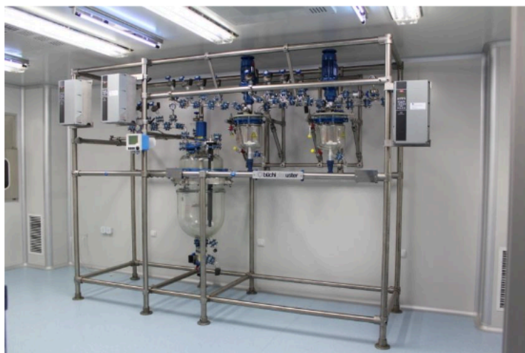
Фото 1 - Оснащенное состояние чистого помещения класса С
