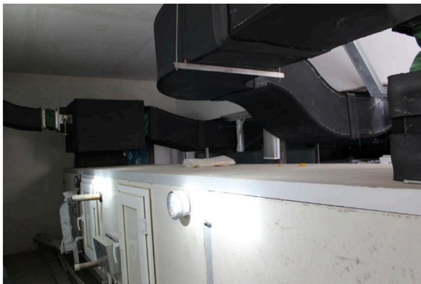
Рисунок 3 - Вентиляционная камера в пространстве «двойного потолка»
