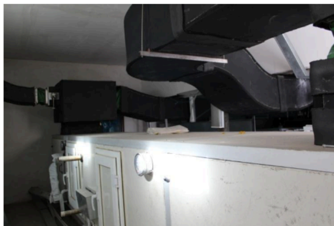
Рисунок 3 – Вентиляционная камера в пространстве «двойного потолка»
